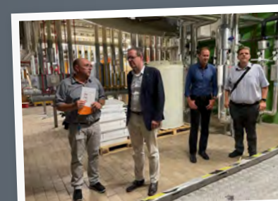
In der Heizzentrale des Congress Center Rosengarten
